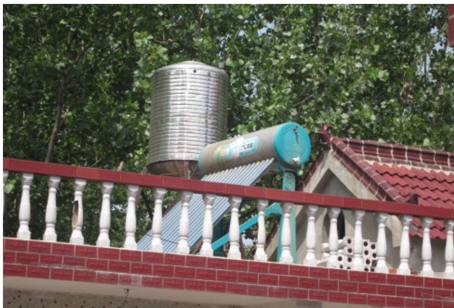
农家房顶的储水罐
